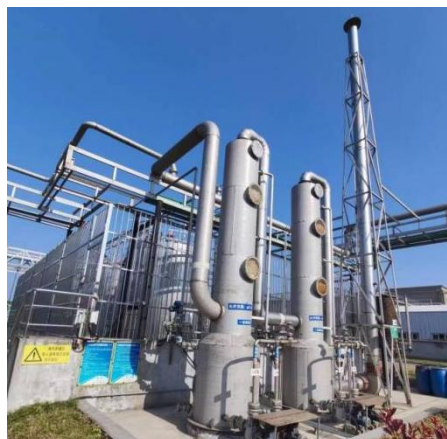
甲类罐区废气排放口 DA010
