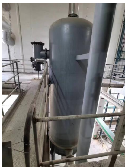
磺化废气处理装置—静电除雾
