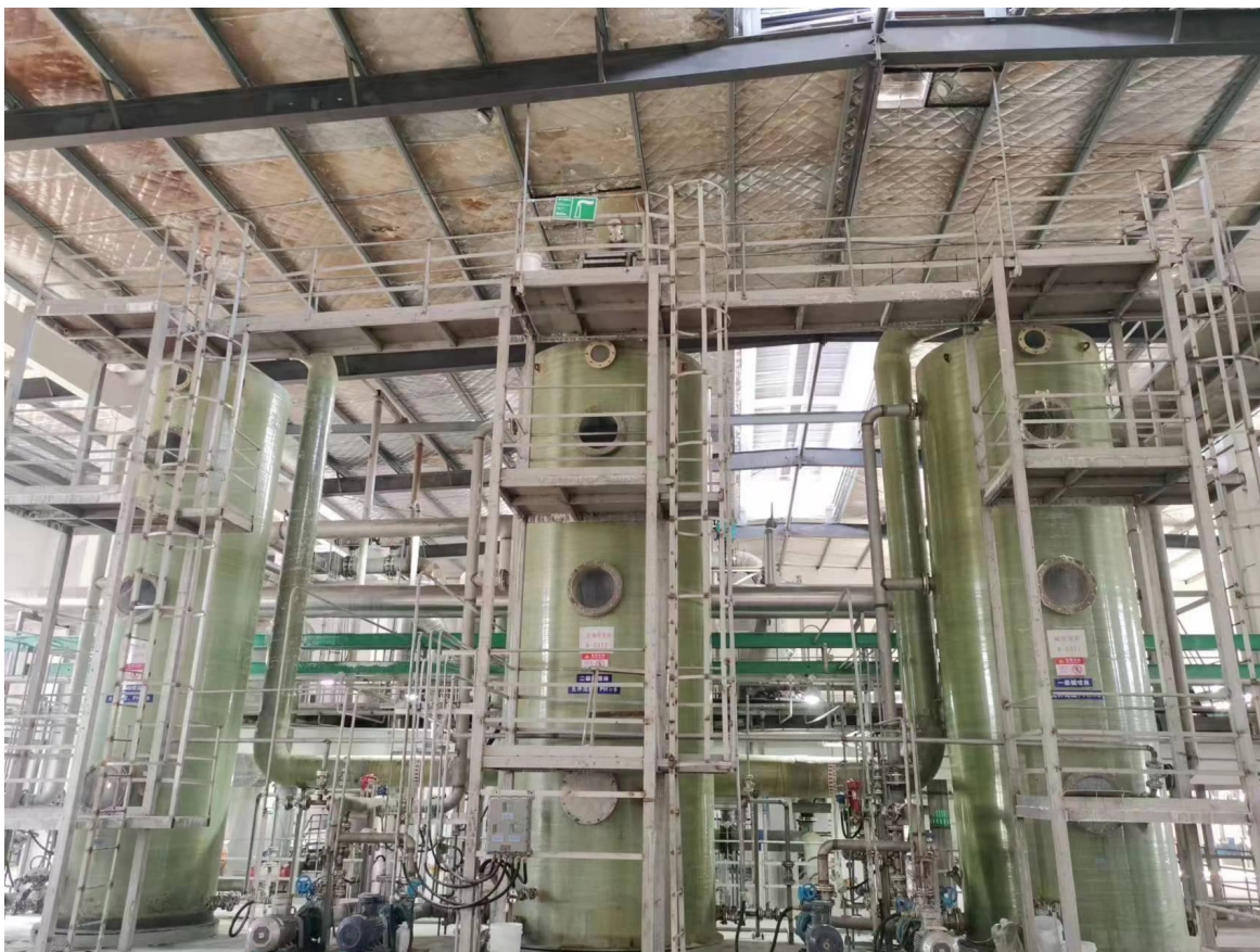
磺化废气处理装置—碱喷淋
