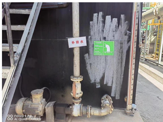
废水总排口 DW001
