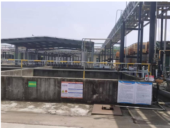
初期雨水收集池标牌
