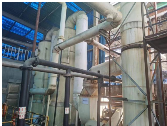
污水站及危废库废气处理装置
