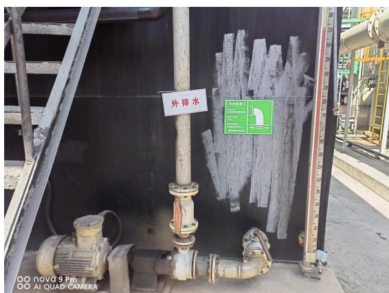
废水总排口 DW001
