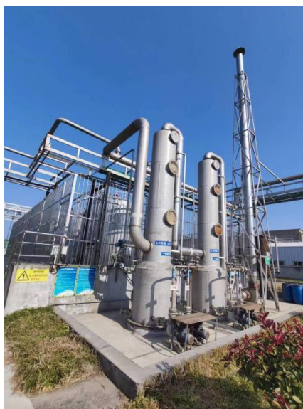
甲类罐区废气处理装置
