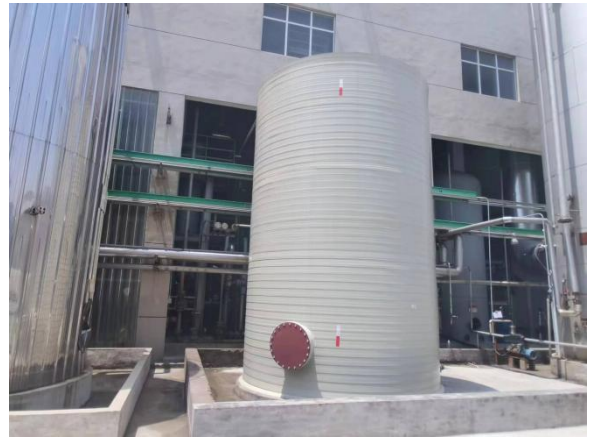
车间废水收集罐
