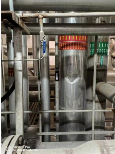
架空雨污管线
